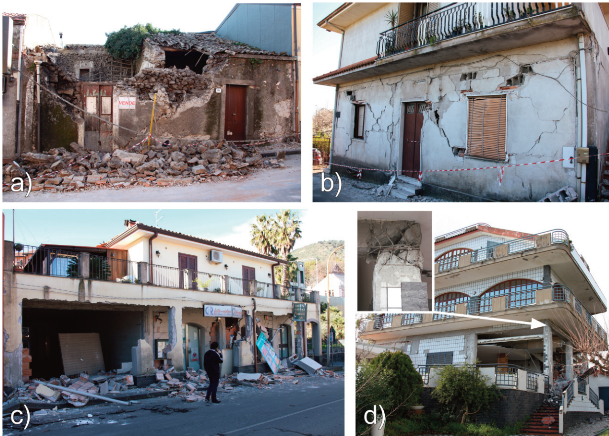
Foto 7 a) Fleri: crollo di un edificio in pietra grezza (cl. A); b) Mazzasette: danno grave (lesioni a croce di S. Andrea, grado 3) ad un edificio in muratura (cl. B); c) Fleri: rottura dei tramezzi in un edificio in c.a. (cl. C); d) Mazzasette: rottura dei pilastri e crollo delle tramezzature (grado di danno 4) in un edificio in c.a. (cl. C).
